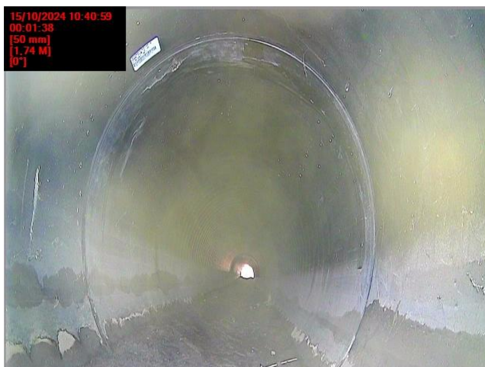
Figura 23 – Fotografia interna da tubulação inspecionada – sistema de drenagem de águas pluviais da BR-116, em Guarulhos/SP.
